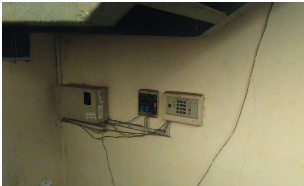
Fotografía 2: Sistema de Alarmas sin Funcionamiento con tendido de cables aéreo
