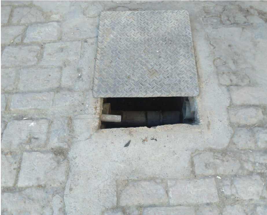
Fotografía 7: Cámara de Acceso Desagüe Cloacal
