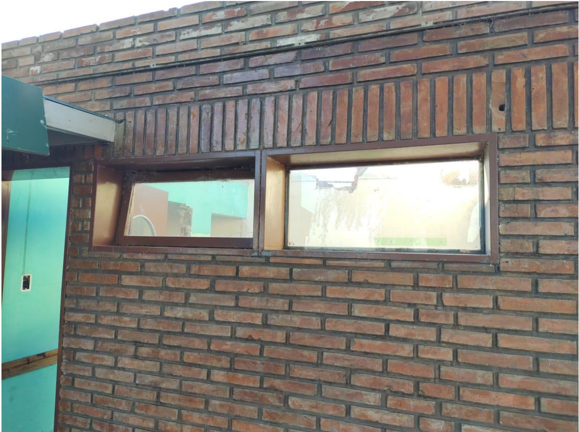
Fotografía 1: Baños – Pared externa (Ambiente 05)
