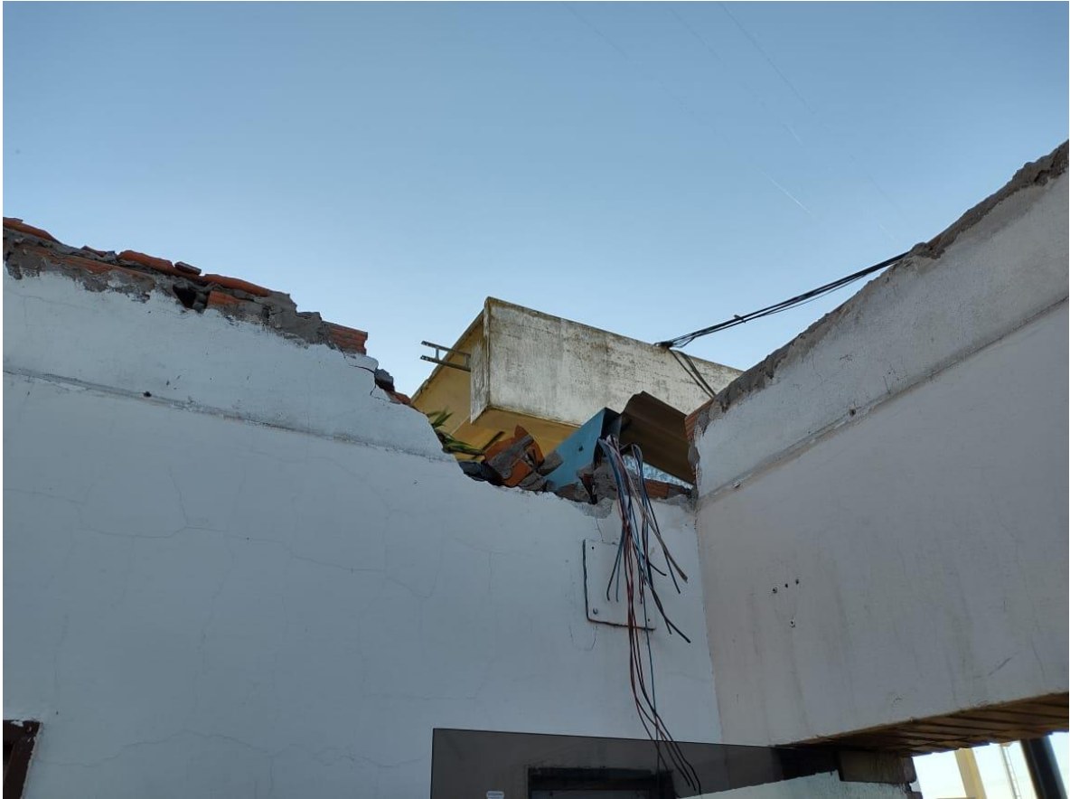
Fotografía 12: Estado actual de las instalaciones eléctricas, las mismas se encuentran a la intemperie. Deberán reconstruirse de acuerdo al criterio del cómputo realizado.
