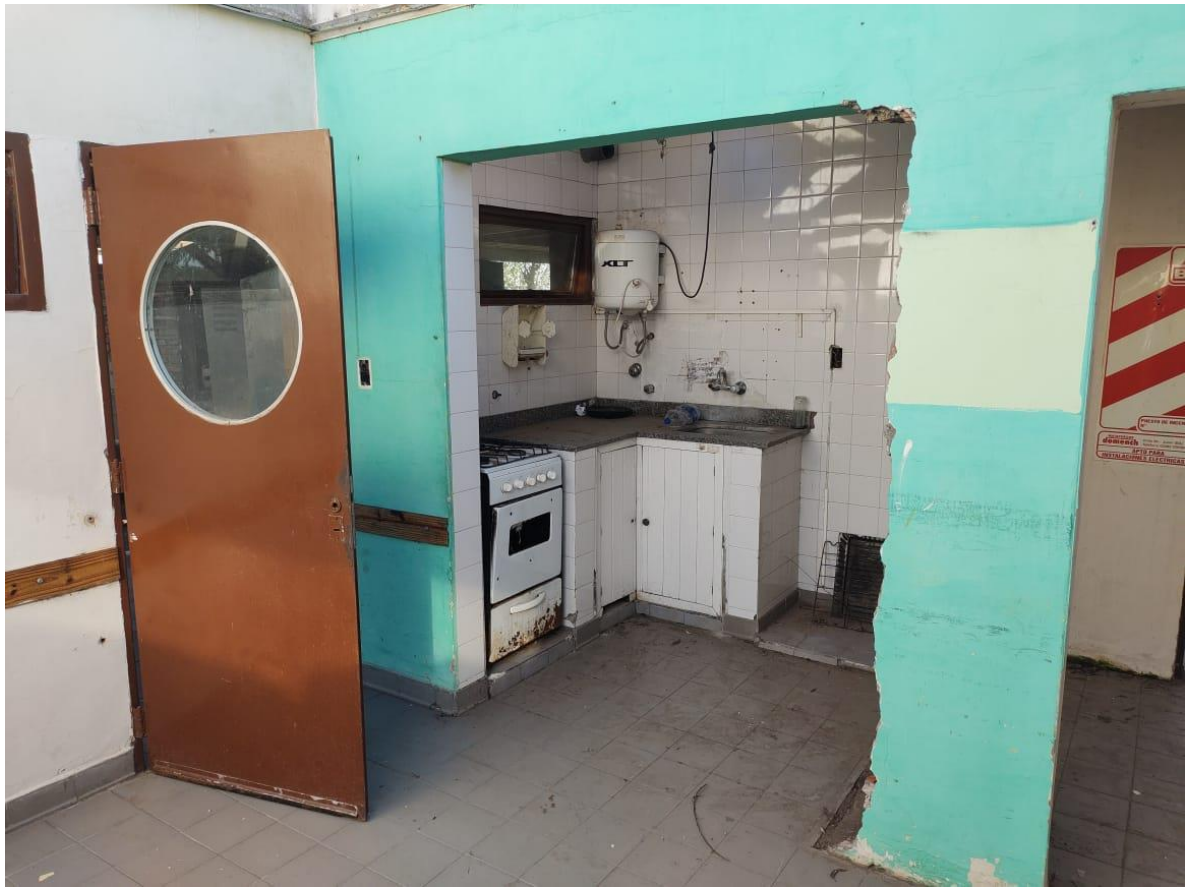
Fotografía 6: Cocina – Comedor – Mobiliario a reemplazar (Ambiente 07)
