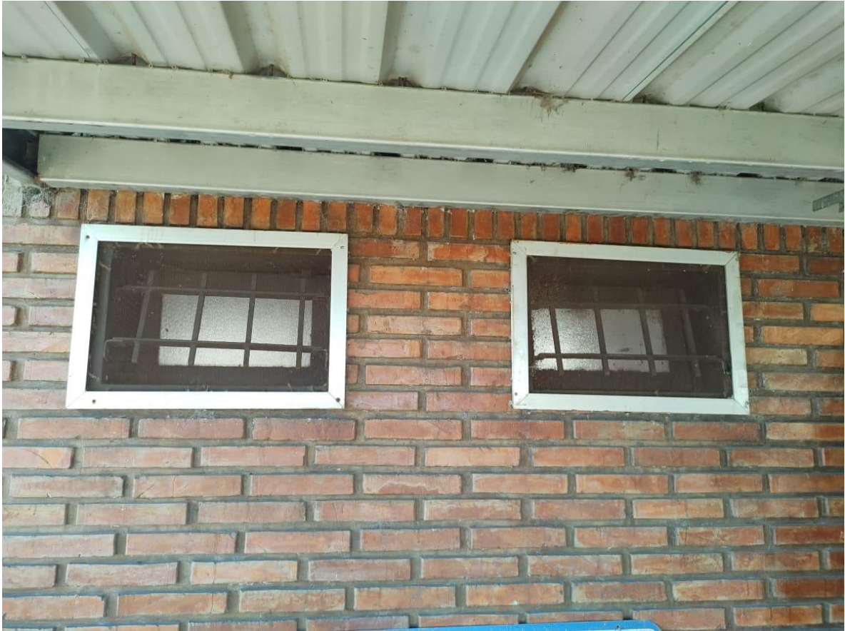
Fotografía 2: Baños – Pared externa (Ambiente 05)
