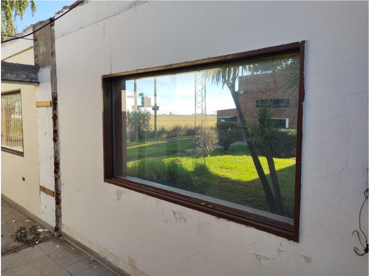
Fotografía 7: Fotografía del estado general de los marcos de aberturas internas existentes – Hay aberturas a la intemperie que están perdiendo su calidad. (Marcos del lado interno).
