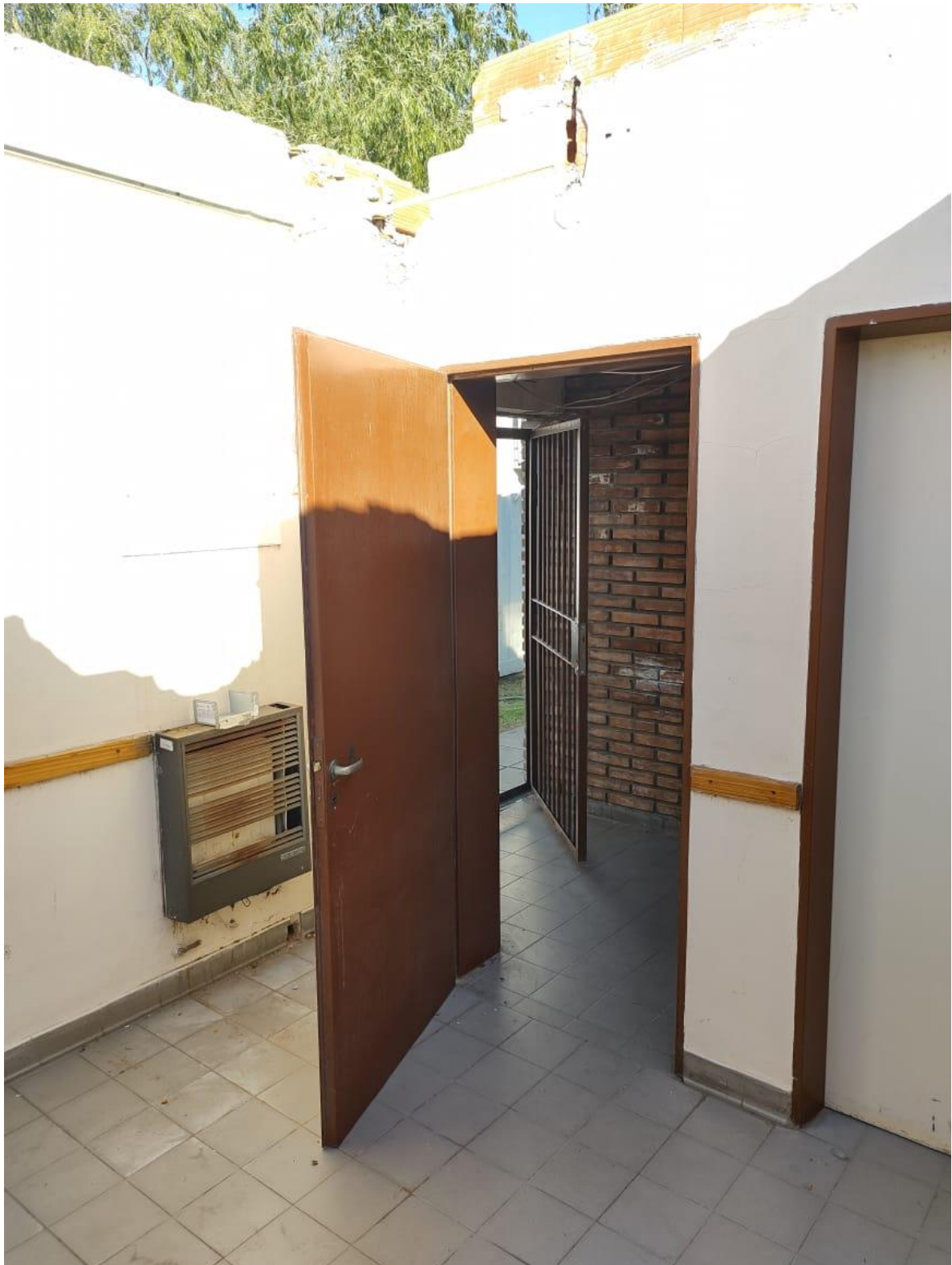
Fotografía 11: Actual salida secundaria o de emergencias. (Ambiente 07)
