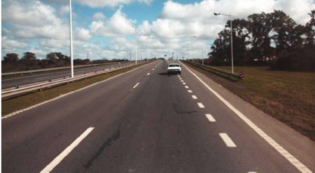
Km. 72,000 - FISURAS RAMIFICADAS ALTERNADAS EN AMBAS HUELLAS DEL CARRILEXTERNO, ALGUNAS SELLADAS EN PARTE.
