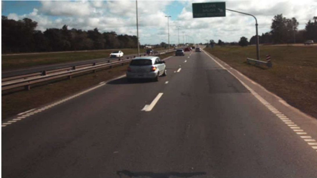
Km. 66,000 - SALIDA LUJAN (PTE. BESCHTEDT). BACHEOS ASFÁLTICOS EN HUELLAS DEL CARRIL EXTERNO. BANQUINA EXTERNA. CARRIL INTERNO EN BUENAS CONDICIONES.
