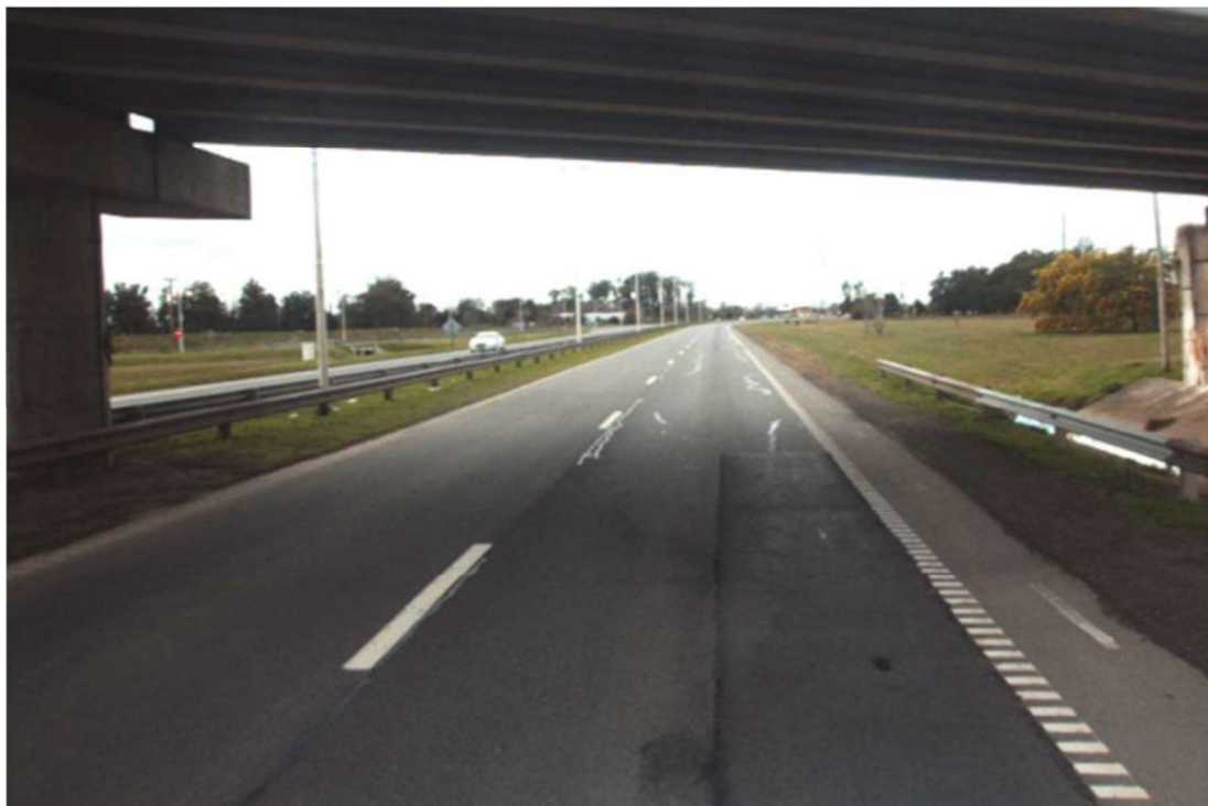
Km. 71,800 - BAJO NIVEL PTE. ROCA. BACHEOS ASFÁLTICOS Y FISURAS LONGITUDINALES RAMIFICADAS CON SELLO ASFÁLTICO QUE LAS CUBRE PARCIALMENTE.
