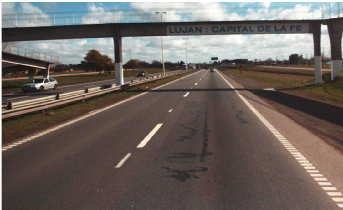
Km. 64,400 - BACHEOS CON FISURAS RAMIFICADAS Y SELLOS ASFÁLTICOS, SUPERADOS POR EL AVANCE DE LAS FISURAS. ALGUNAS FISURAS TRANSVERSALES.
