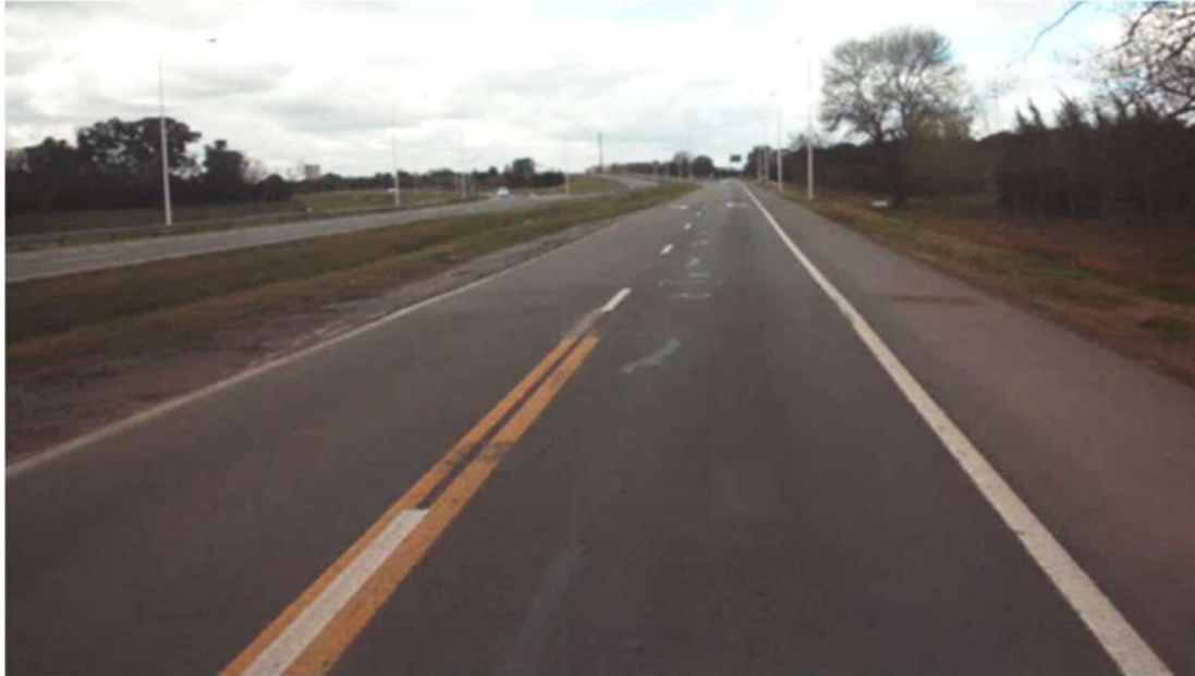
Km. 74,000 - FISURAS EN CARRIL EXTERNO, RAMIFICADAS CON TAREAS DE SELLADOS. PARTE FINAL DE SECTOR CON BANQUINA PAVIMENTADA EN 2,50 M. DE ANCHO.
