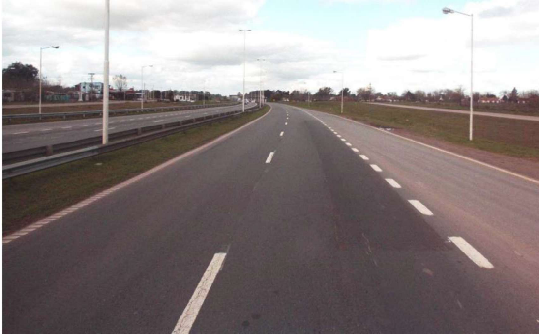
Km. 64,900-SECTOR CON FISURAS INTERCONECTADAS, FINAS Y BACHEOS ASFÁLTICOS EN BUENAS CONDICIONES, EN CORRESPONDENCIA CON RAMA DE INGRESO LATERAL. CARRIL INTERNO, MUESTRA MEJORES CONDICIONES.
