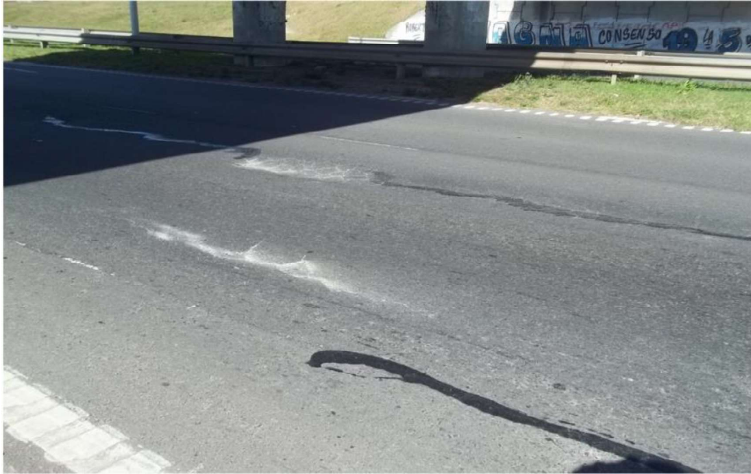
Km. 69,100 (BN. RP 192) - FISURAS EN MALLAS (TIPO 8) CON HUNDIMIENTOS AFECTANDO CARRIL EXTERNO, A LO LARGO DE UNA LONGITUD DE 50 M. APROX. CARRIL INTERNO, CON FISURAS LONGITUDINALES CON SELLOS.
