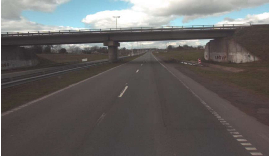
Km. 69,150 (R.P. 192) - BACHEOS ASF. Y FISURAS RAMIFICADAS CON DESPRENDIMIENTOS DETERIOROS EN CARRIL EXTERNO. CARRIL INTERNO EN BUENAS CONDICIONES.
