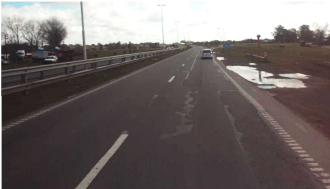
Km. 67,500 - PROXIMIDADES DE LA SALIDA A LA BASÍLICA BACHEOS Y FISURAS RAMIFICADAS, ALGUNAS CON TAREAS DE SELLADOS. BUENAS CONDICIONES DEL CARRIL INTERNO.
