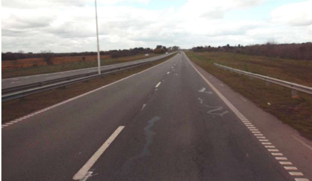
Km. 72,000 - FISURAS RAMIFICADAS CON SELLOS Y FORMANDO MALLAS CERRADAS. CARRIL INTERNO EN BUENAS CONDICIONES.
