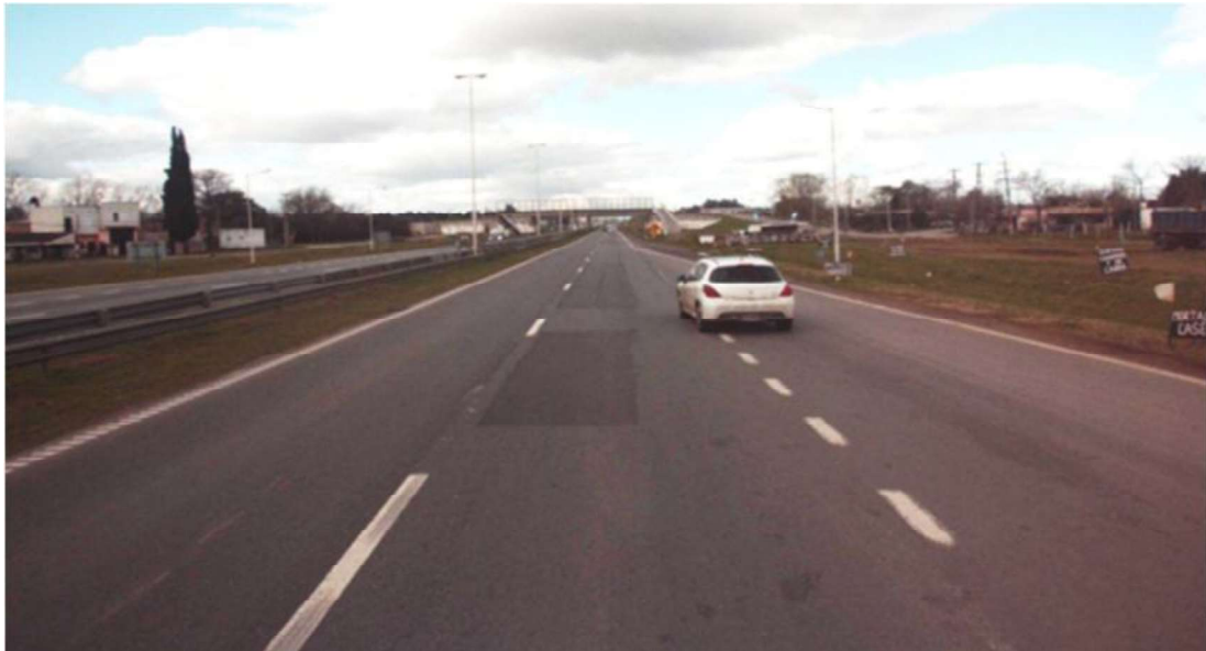
Km. 67,700 - BACHEOS ASFÁLTICOS EN EL ANCHO DE LA HUELLA INTERNA O EXTERNA DEL CARRIL EXTERNO. PERFIL CONSERVADO DEL CARRIL INTERNO CON POCA CANTIDAD DE FISURAS.
