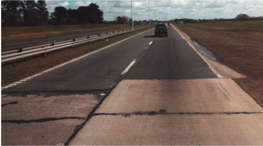
Km. 63,600 - INICIO DE TRAMO LUEGO DE LAS LOSAS DE HORMIGÓN BACHEOS CON FISURAS RAMIFICADAS EN AMBAS HUELLAS DEL CARRIL EXTERNO. EN CARRIL INTERNO, FISURAS RAMIFICADAS CON SELLO ASFÁLTICO.
