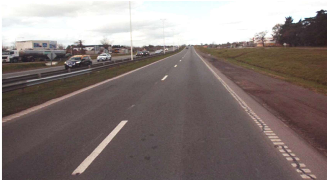
Km. 65,600 - ASPECTO DE CAPA DE RODAMIENTO ALGO AMASADA EN SECTORES DE LAS HUELLAS DE AMBOS CARRILES. FISURAS LOCALIZADAS, RAMIFICADAS CON TENDENCIA A FORMAR MALLAS CERRADAS Y BACHEOS ASFÁLTICOS
