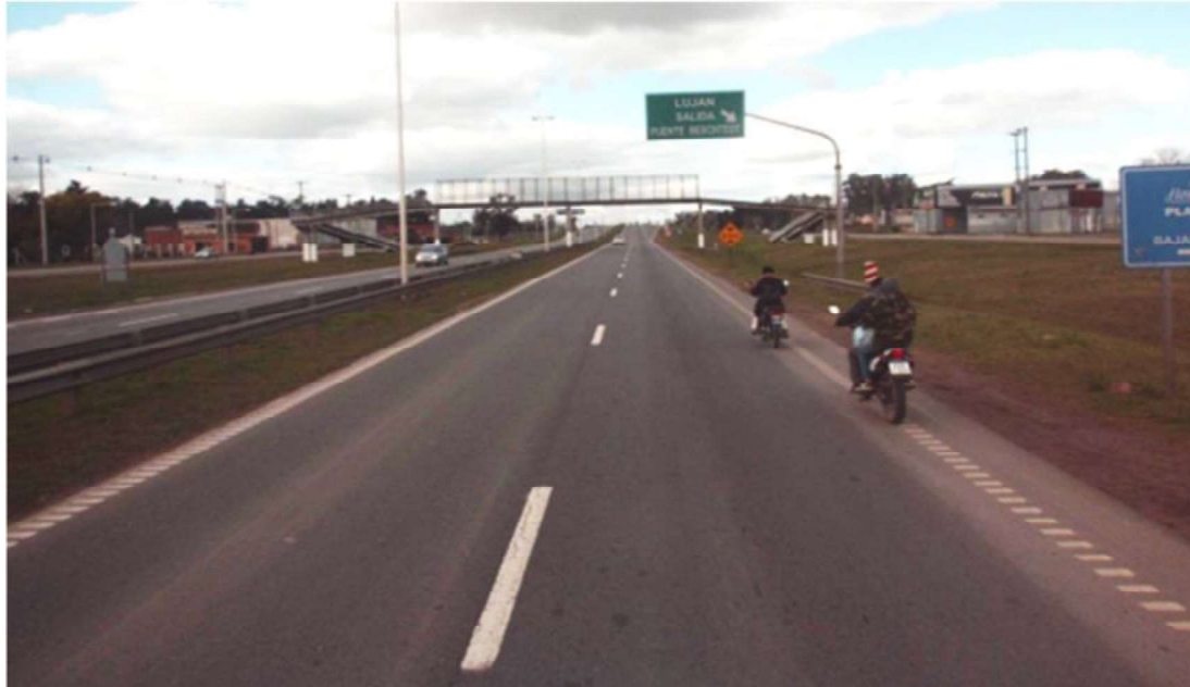
Km. 67,000 - LUEGO DEL PTE. GALVEZ, SECTOR EN MEJOR ESTADO SUPERFICIAL. MENOS FISURAS EN AMBOS CARRILES. LEVE AMASADO DE HUELLAS EN CARRIL EXTERNO.
