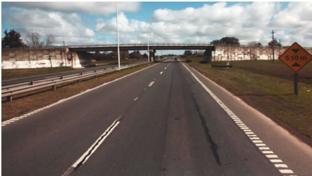
Km. 70,500 - HUELLAS CON FISURAS Y BACHEOS ASFÁLTICOS NUEVAMENTE FISURADOS. AHUELLAMIENTOS MODERADOS.
