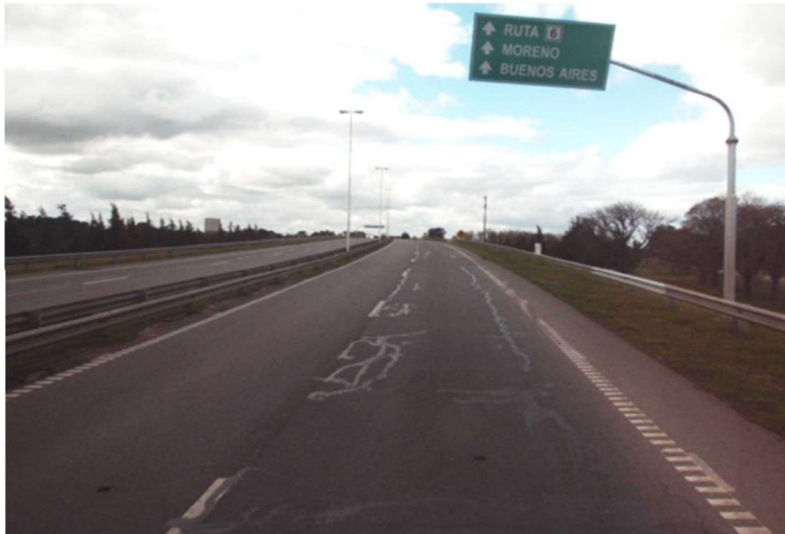
Km. 73,600 - ALTO NIVEL CON FISURAS RAMIFICADAS EN AMBAS HUELLAS DETERIOROS FOCALIZADOS SOBRE EL CARRIL EXTERNO.
