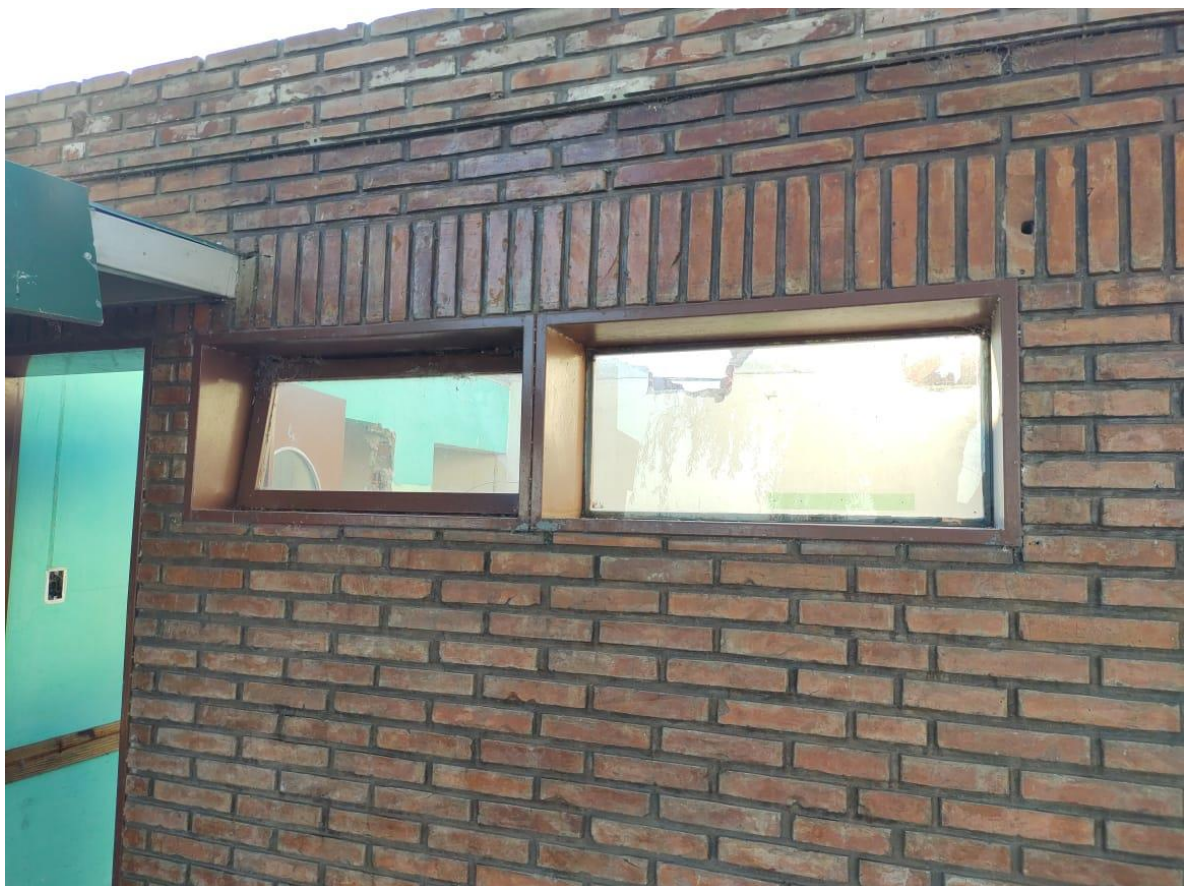
Fotografía 1: Baños – Pared externa (Ambiente 05)
