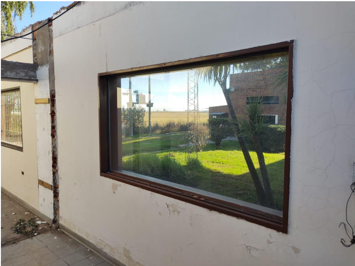
Fotografía 7: Fotografía del estado general de los marcos de aberturas internas existentes – Hay aberturas a la intemperie que están perdiendo su calidad. (Marcos del lado interno).
