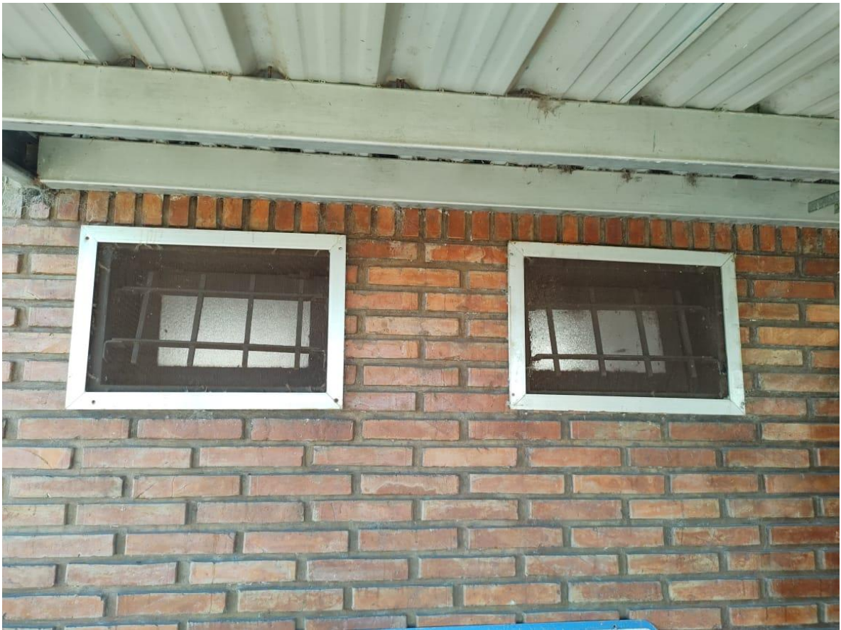
Fotografía 2: Baños – Pared externa (Ambiente 05)
