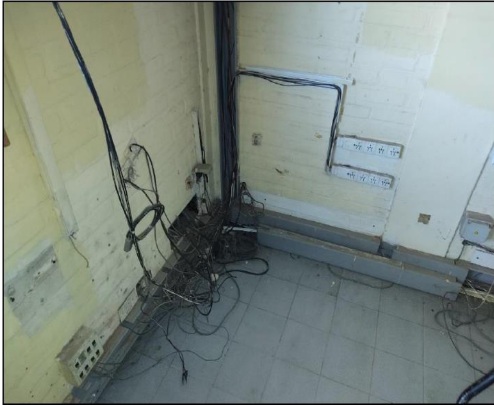
Fotografía 3: Sistema de Alarmas sin Funcionamiento con tendido de cables aéreo
