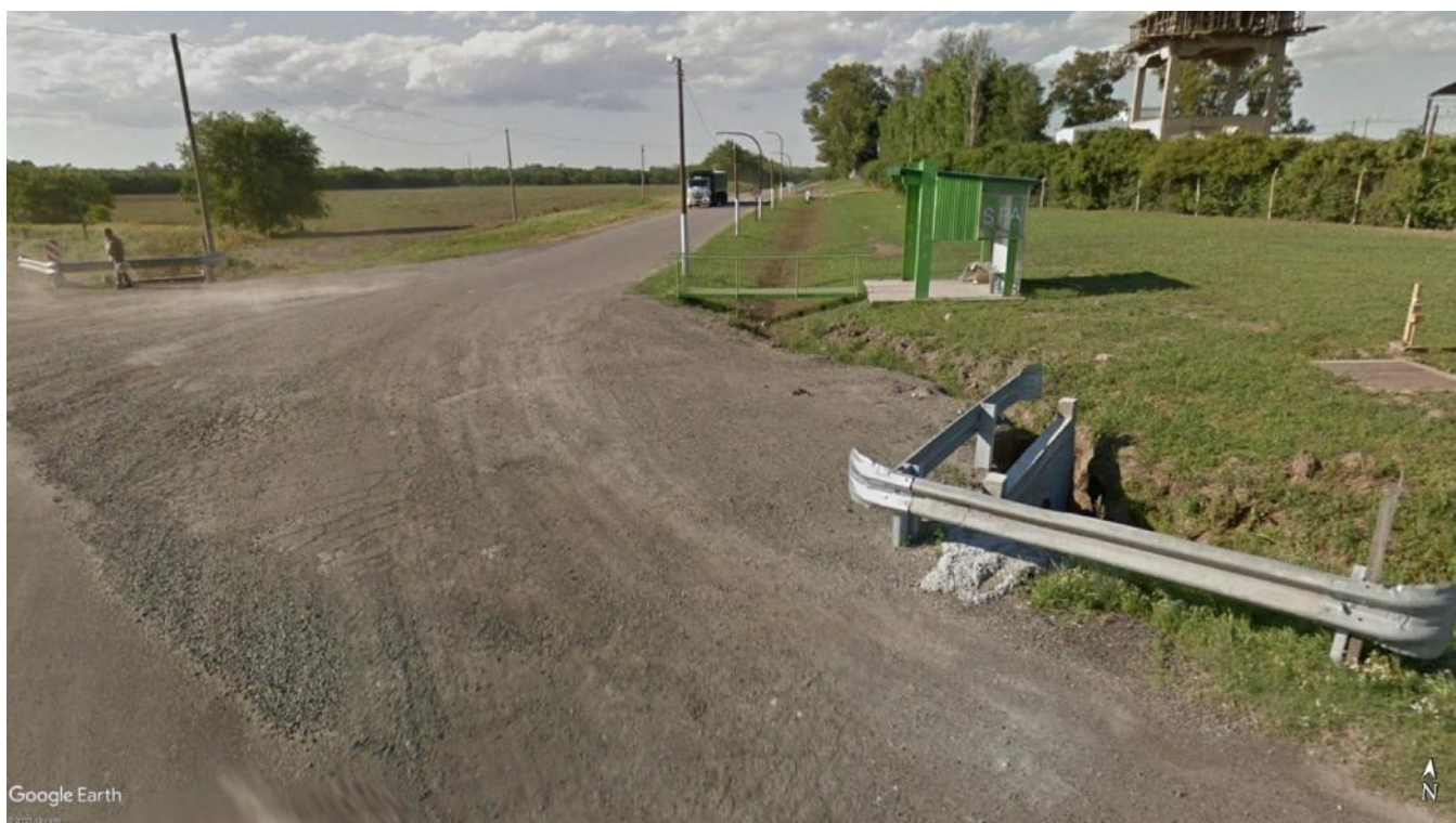
Imagen 3.8 – Vista de barandas metálicas de defensa a retirar en Acceso (Lado Asc.)
